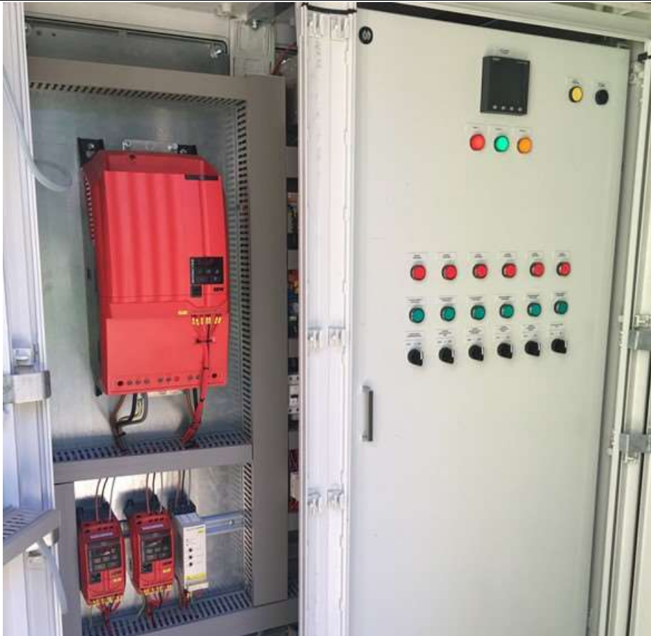
Figura 3. Vista global do Quadro Elétrico
