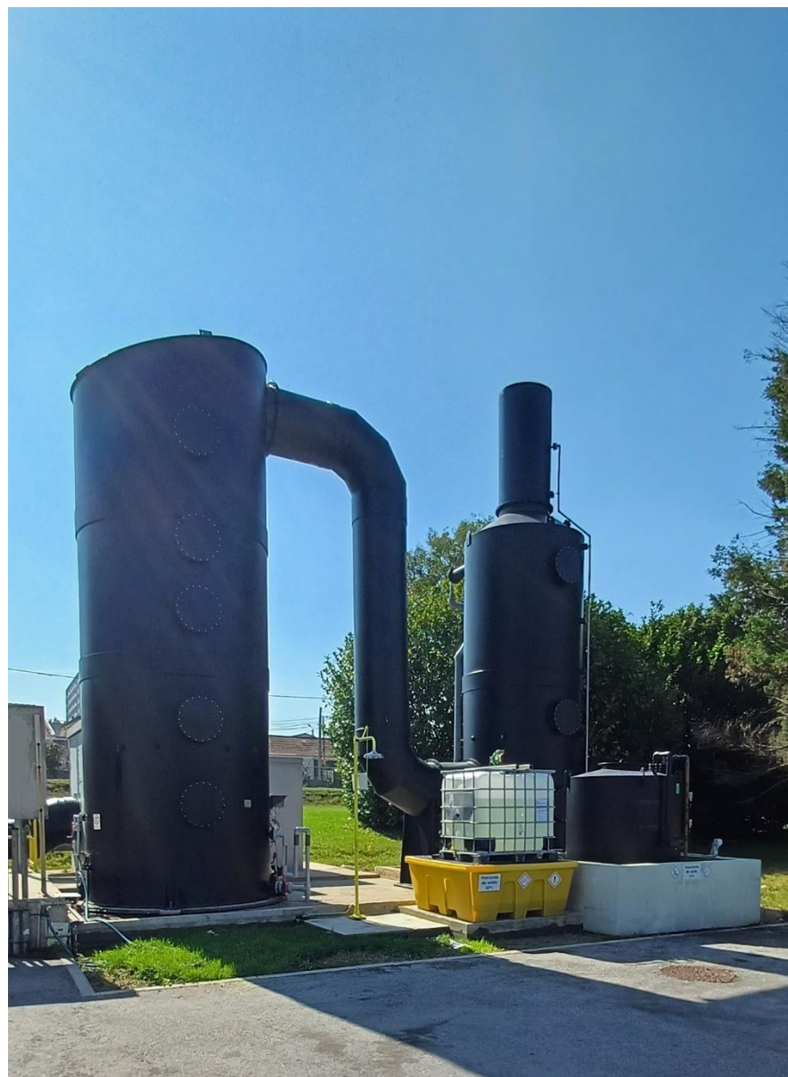
Fotografia 1.4 - Núcleo de desodorização adstrito ao tratamento primário existente.
