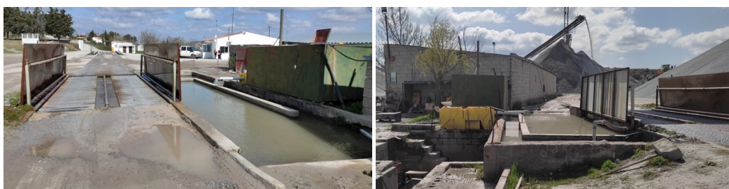
Figura 8: Sistema de lavagem de rodados.
