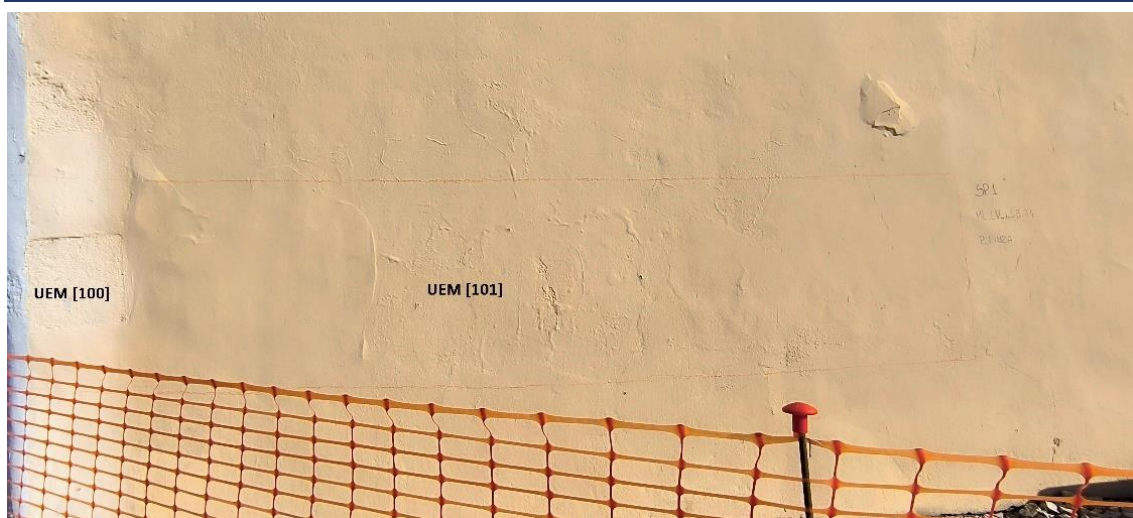
Figura 38 – Camadas de tinta superficiais na SP1.
