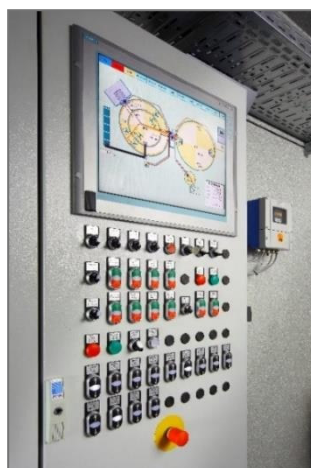
Figura III.23 – Armário de Controlo
