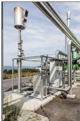
Figura III.26 – Queimador de emergência (flare)
