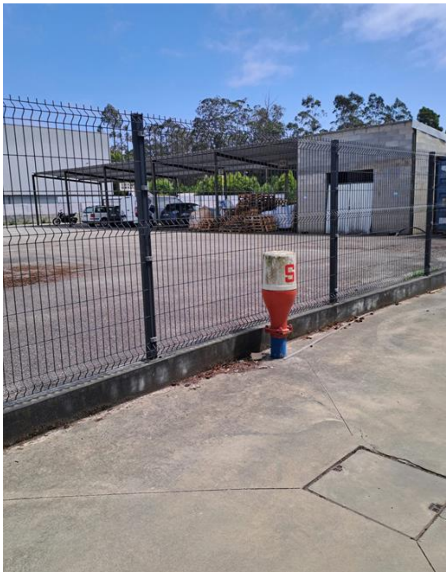
Hidrante SI localizado na lateral da unidade fabril
