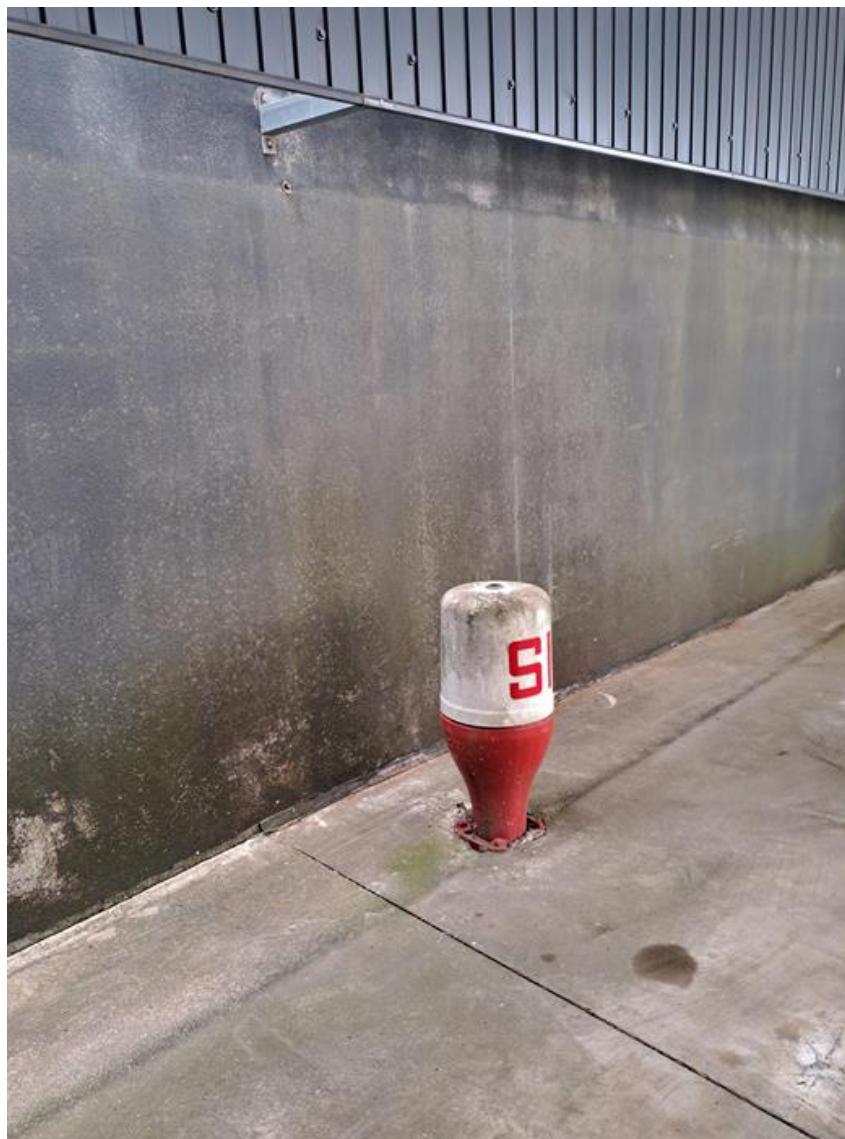
Hidrante SI localizado nas traseiras da unidade fabril
