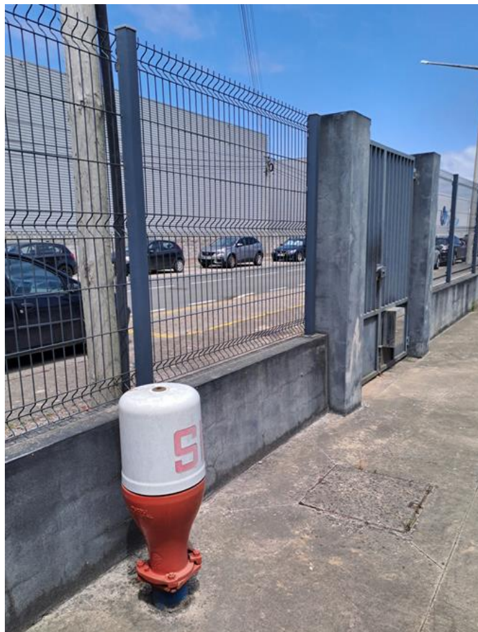
Hidrante SI localizado na frente da unidade fabril
