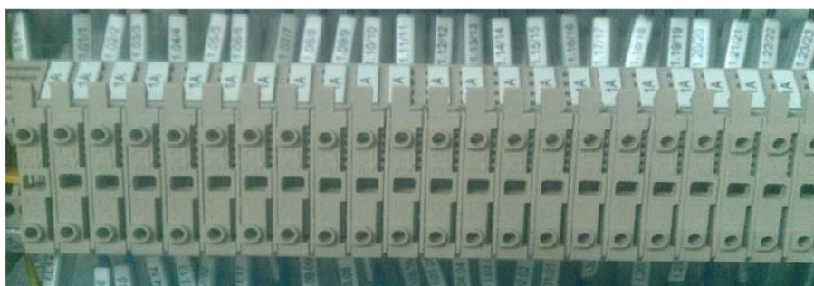
Figura 2 - Fusíveis das válvulas.
