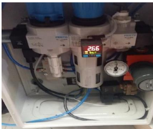
Figura 13 - Filtro e manômetro de pressão.
