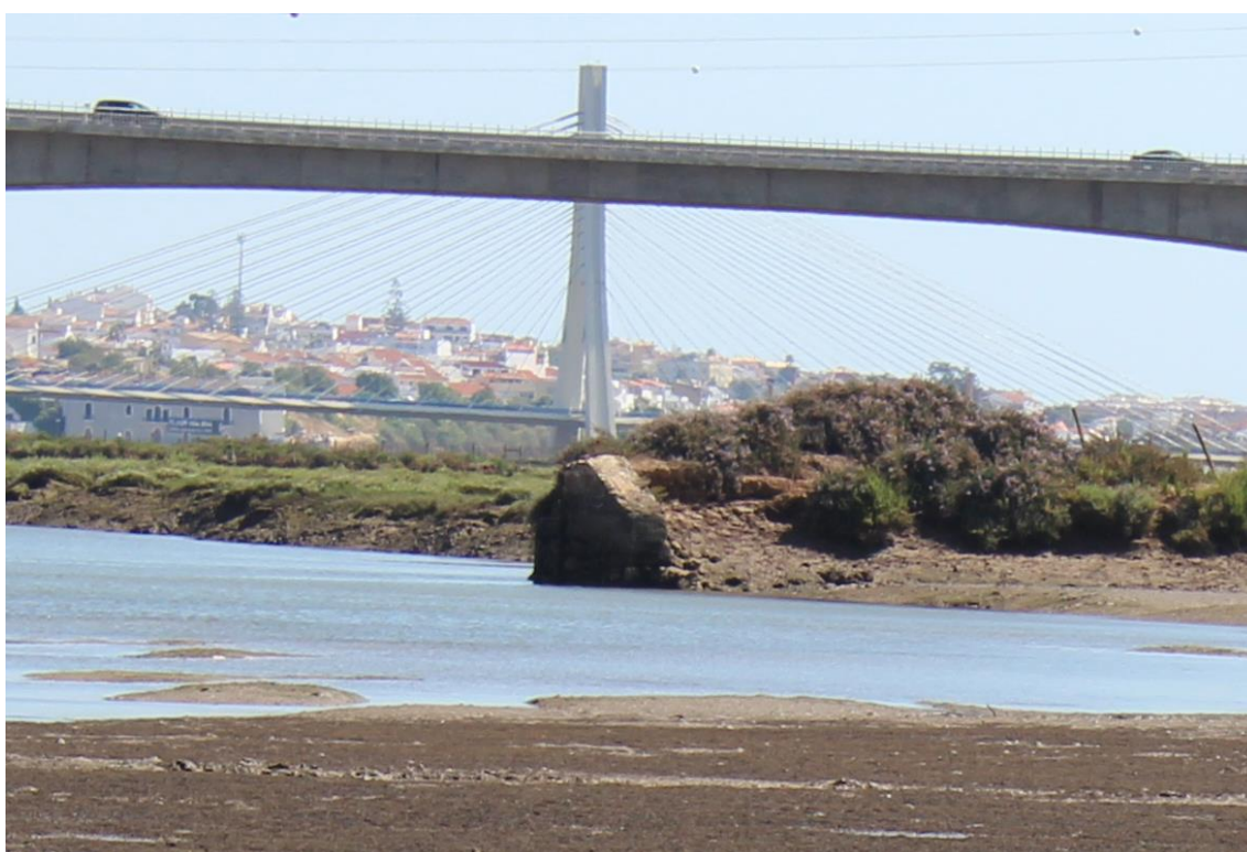
Figura 40 – Dique destruído (106A) com elemento de parte da estrutura da comporta (151B).
