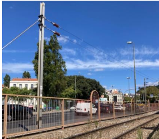
Figura 2 – Terminação da eletrificação da Linha de Cintura
