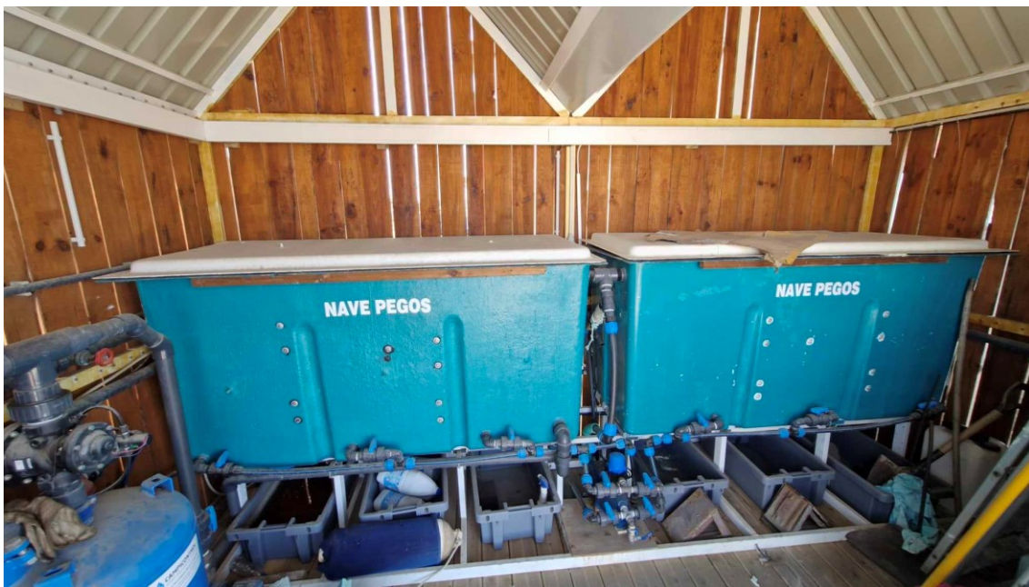
Sistema de filtragem.
