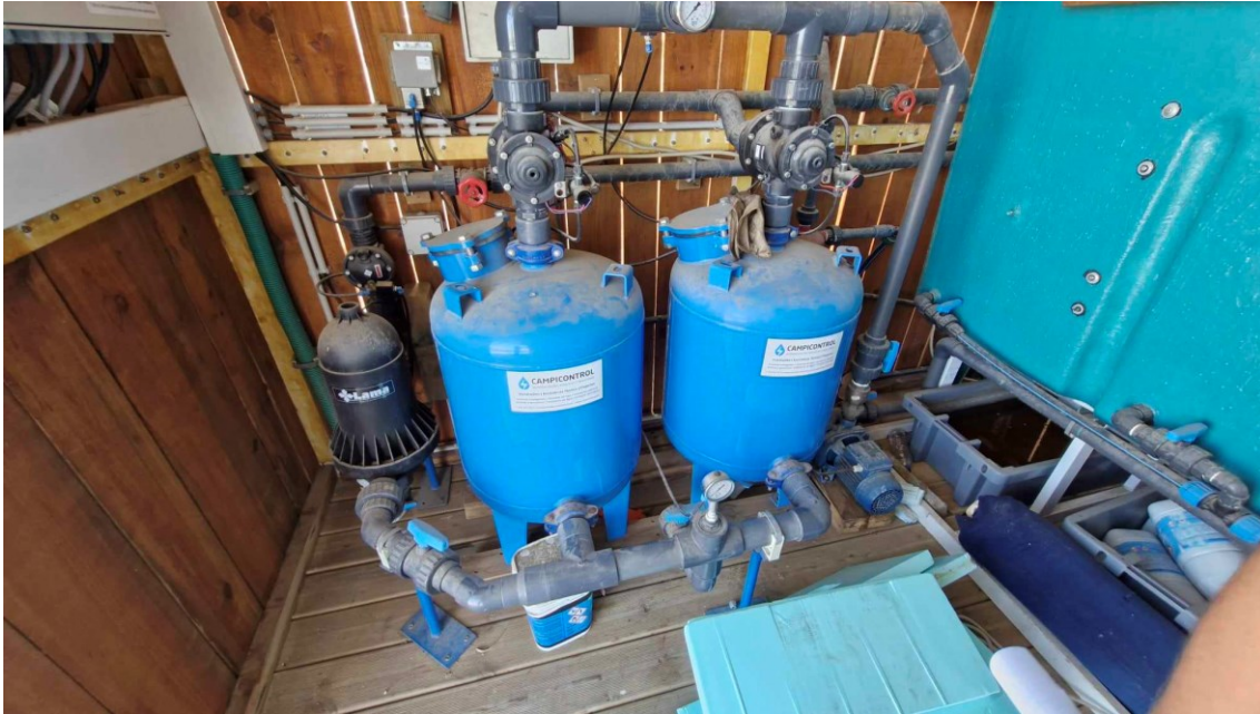
Sistema de filtragem.
