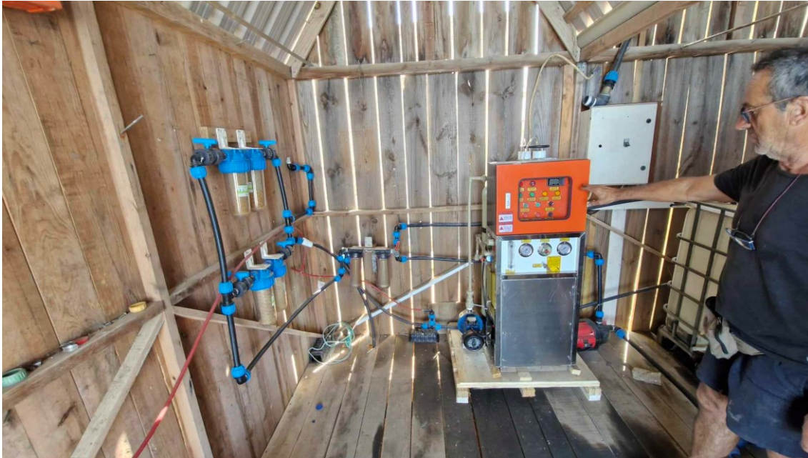
Sistema de dessalinização instalado.
