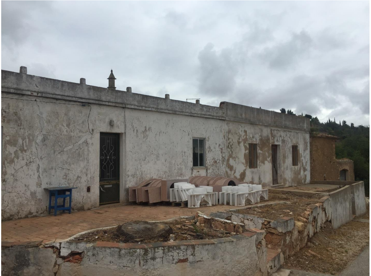
Fig. Habitações a demolir
