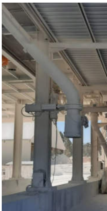
Figura 8 - Sistema de enchimento de big bags instalado
