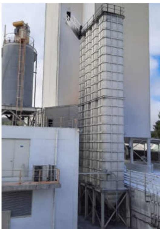
Figura 4- Fotografia sistema de armazenagem de combustível sólido instalado
