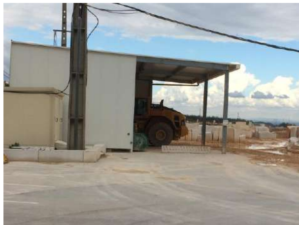
Foto 11 – PT em cabine. Pavilhão destinado a ferramentas, consumíveis, máquinas, e outros.
