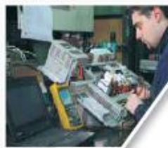
Cableado de cuadro eléctrico Control panel wiring
