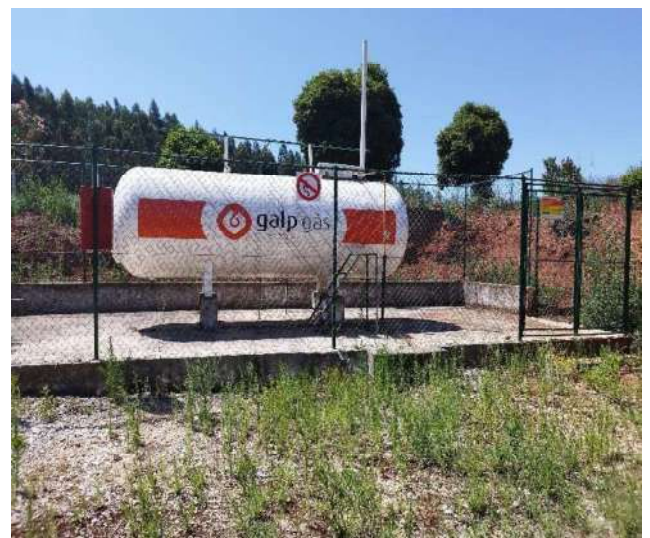
Ilustração 1- Depósito de armazenamento de GPL
