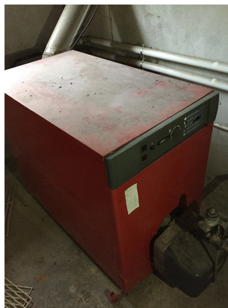
Figura 8.4 – Aquecedor do pavilhão de recria de Sarruadas
