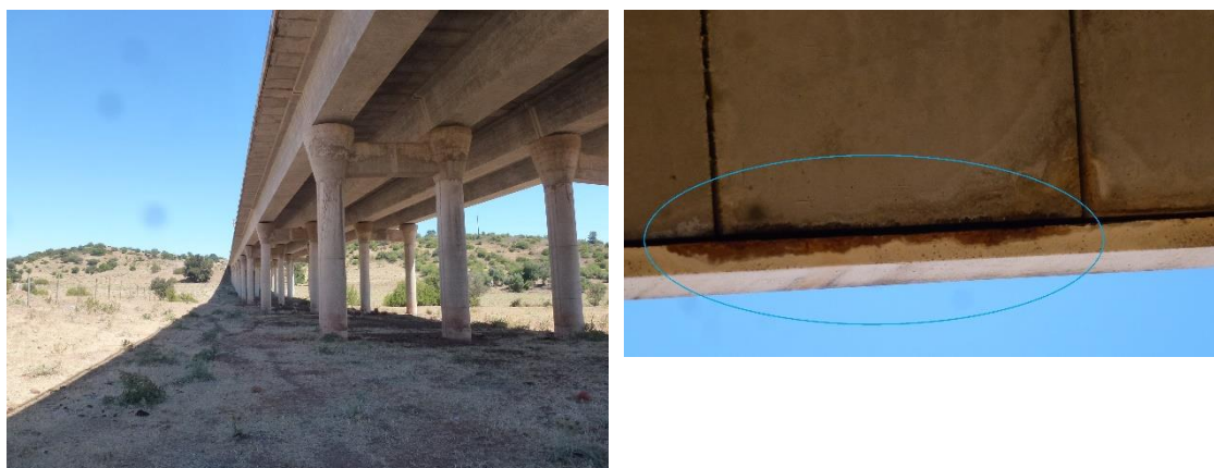
Figura 37 – Viaduto da Autoestrada 22 (AMA01), que atravessa a área de estudo, e indícios de ocorrência de colónia de morcegos (urina).
