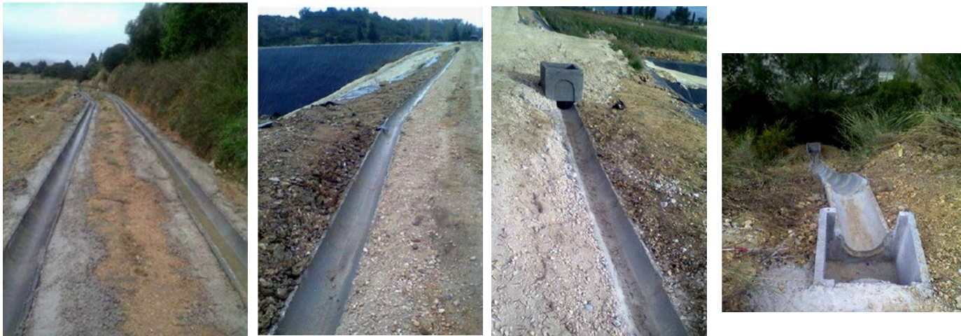
Fotos do Sistema de Valetas de Drenagem / Escoamento implementado
