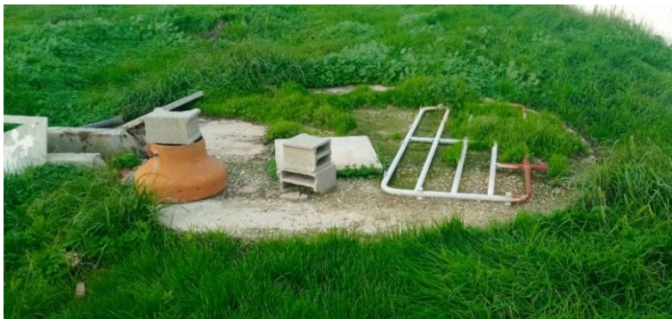
“Caixa 2” de passagem, ligada à lagoa 8
