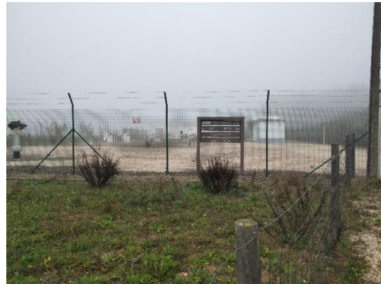
Estação de Regulação de Pressão e Medição da Abrigada: GRMS 1319, onde se prevê a ligação do gasoduto
