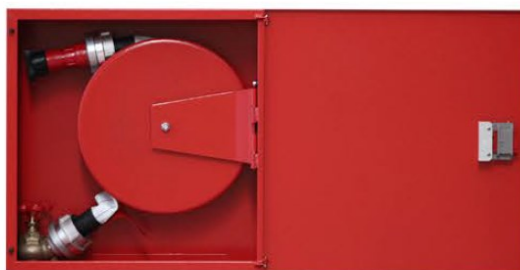
Figura 29- Exemplo de boca incêndio BITT, instalada em armário
