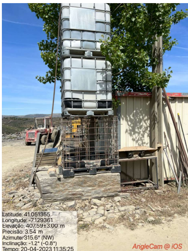
Figura 122: Fotografia dos tanques de armazenamento de água que fornecem água às instalações sociais.
