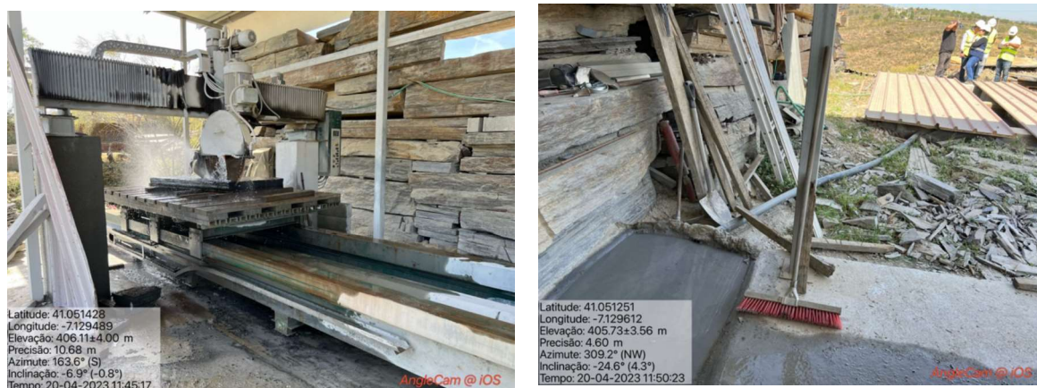
Figura 121: Fotografia da máquina de corte e dos tanques de decantação existentes associados ao sistema de recirculação de águas do corte.
