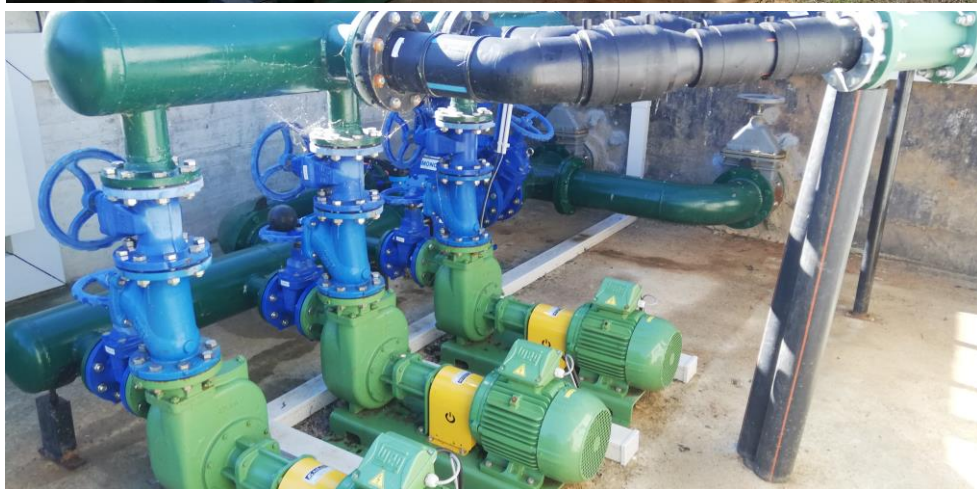
Figura 3 – Equipamento de elevação e medidores de caudal instalados recentemente
