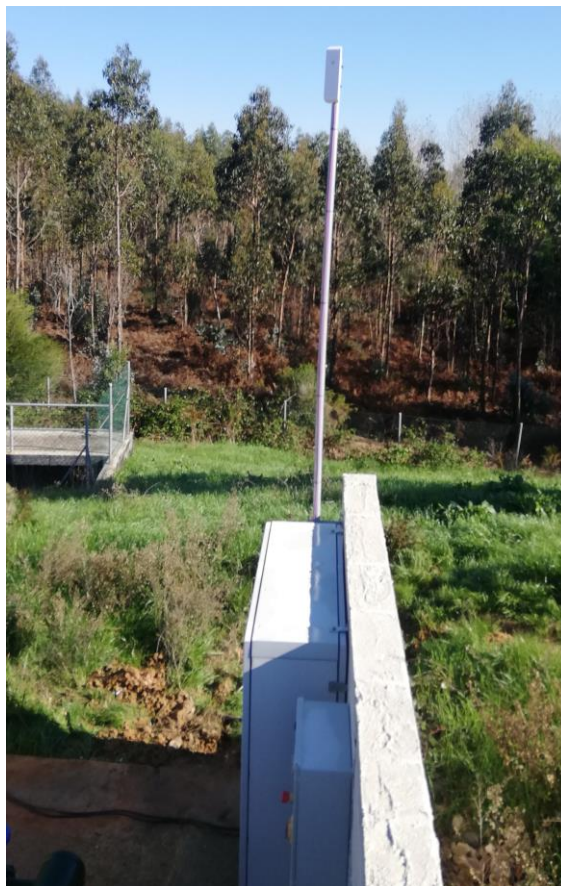
Figura 4 – Sistema de telegestão instalado recentemente
