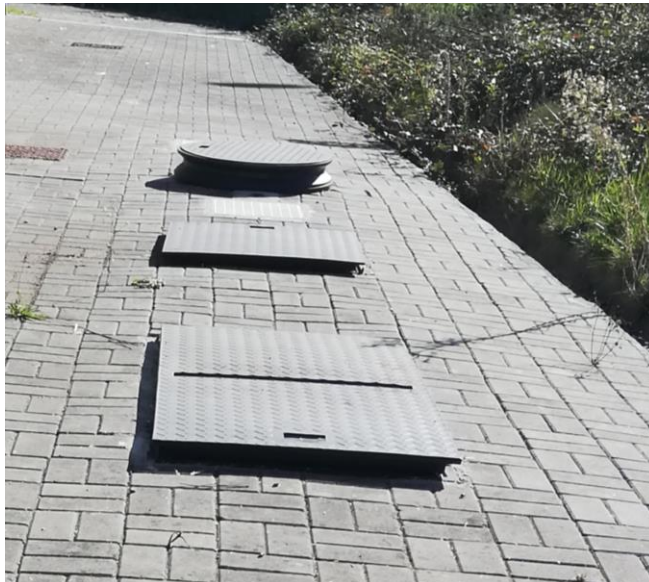
Figura 5 – separador de hidrocarbonetos – plataforma de manutenção de máquinas
