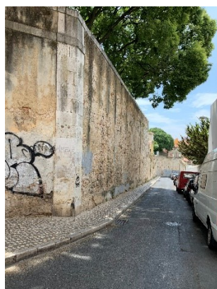
Figura 8 – Fotografia ilustrativa do muro do miradouro Largo das Necessidades, interferência N° 385
