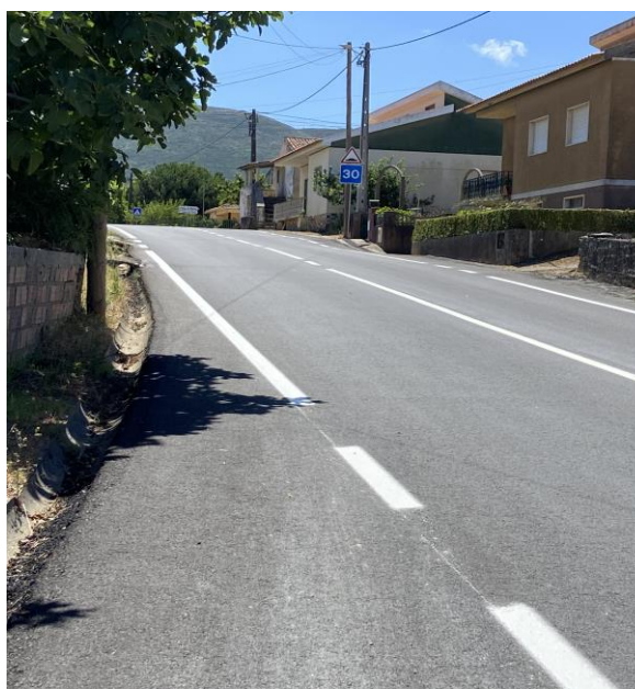
Foto 6 – Sinalização vertical na estrada Lagar dos Frades junto à entrada da pedreira – lombas e velocidade recomendada.
