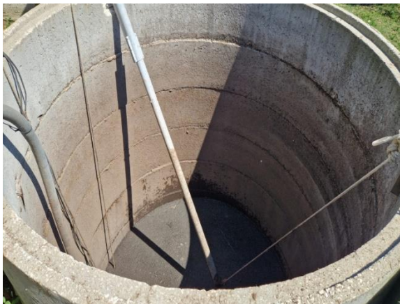
Sistema de Bombagem do Tanque de Receção
