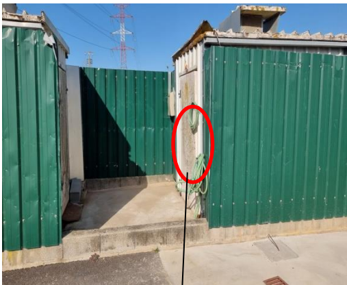
Ponto tomada de água
