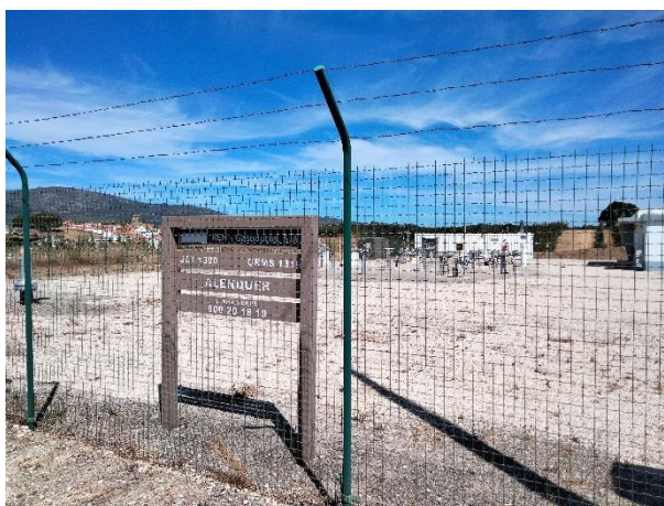
Fotografia 6.19 – Estação de Regulação de Pressão e Medição da Abrigada (GRMS 1319)
