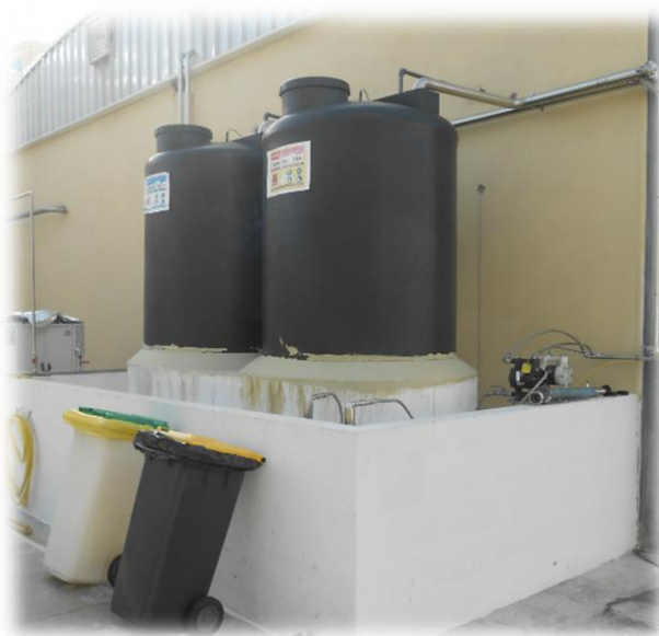
Figura 9 – Depósitos de armazenagem de MP02
