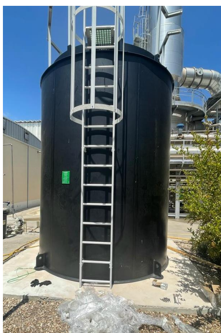
Figura 3- Registo fotográfico do depósito de dupla parede de armazenagem solução alcalina
