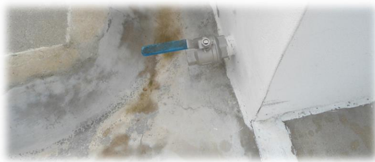
Figura 11 - Válvula de drenagem, no local de armazenagem da substância MP02
