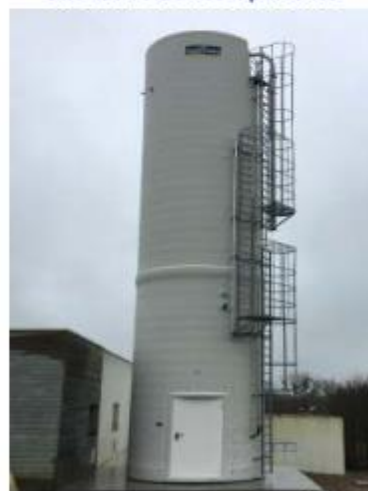
Silo con faldón autoportante
