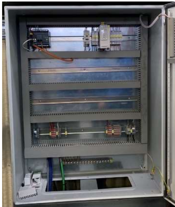
Figura 1: Sistema de Controlo, Gestão e Monitorização de Energia – SCGeME.
