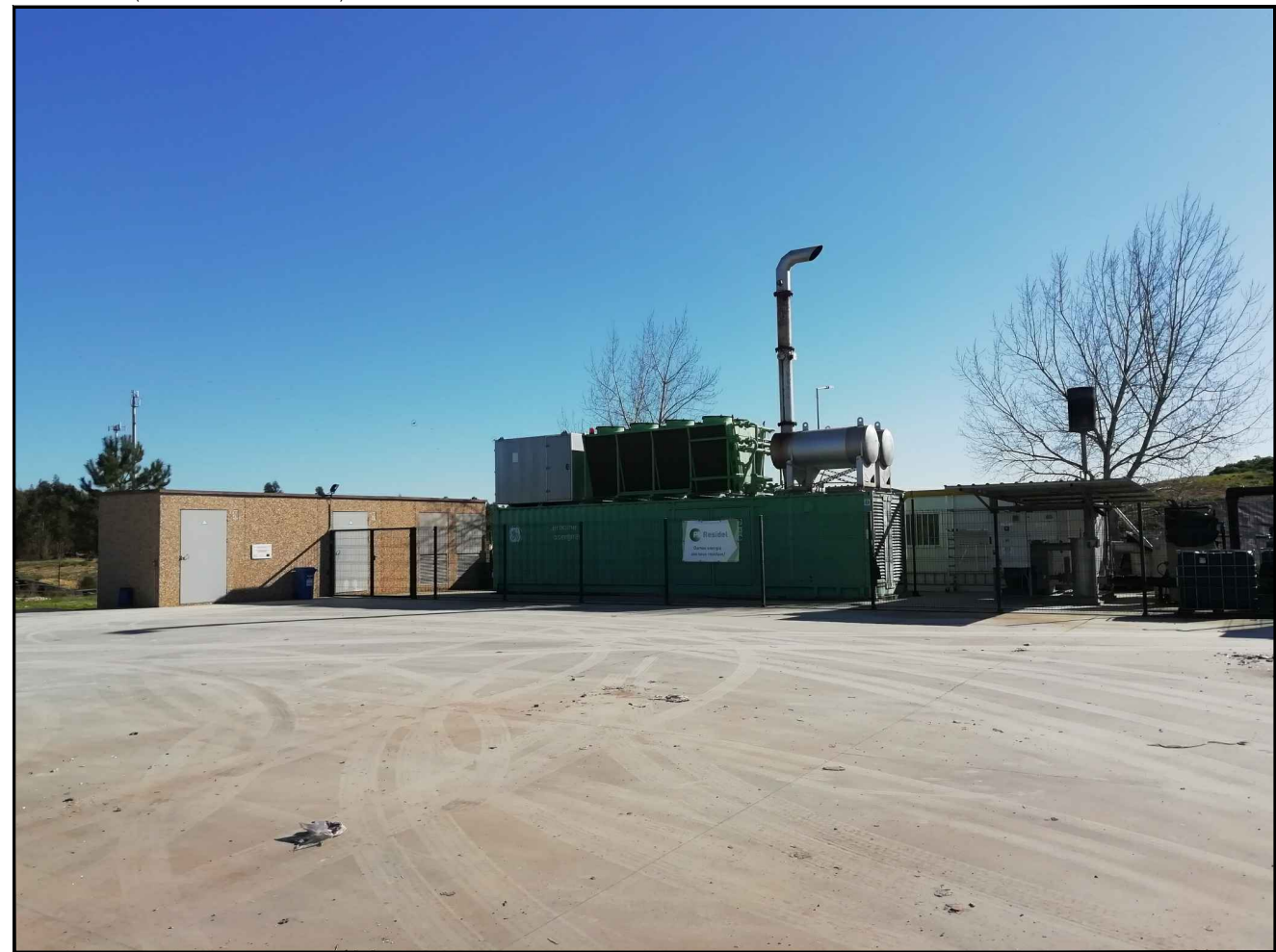
FOTO DA CVE (GRUPO MOTOGERADOR)
