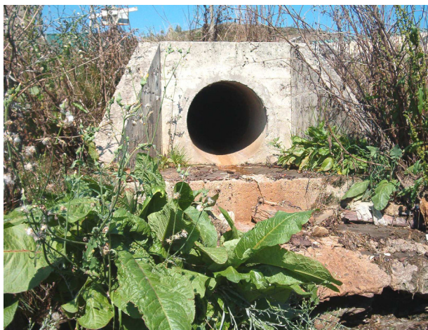
Figura 13 – Ponto de descarga das águas pluviais
