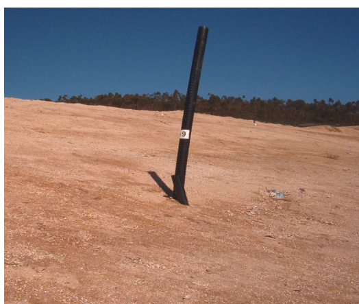
Figura 14 – Poço vertical de captação de biogás.
