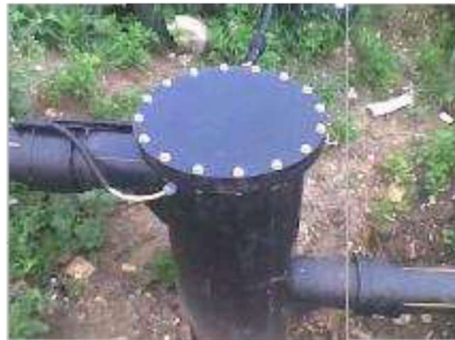
Poço de Condensados Pormenor da Tampa
