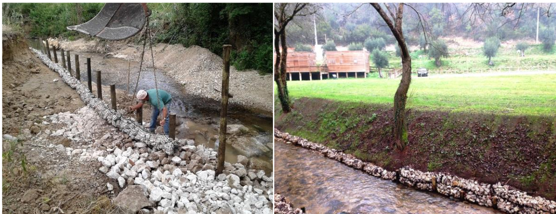
Figura 12 – Aplicação de gabião cilíndrico em margem fluvial (esq.: Ribeira de Seiça, Ourém, 2013 | dir.: Vale do Lapedo, Leiria, 2016). | Fonte: EcoSalix
