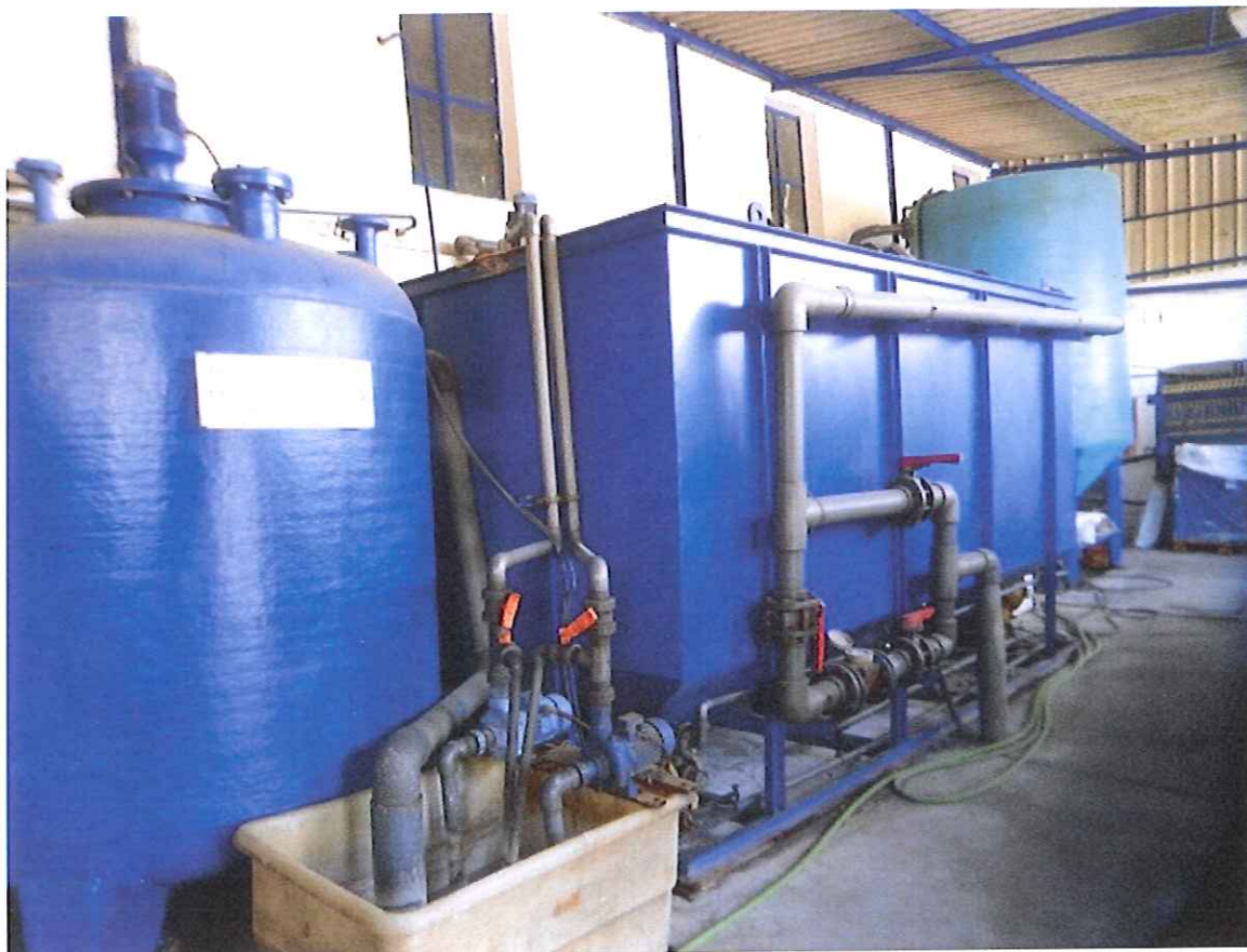
Figura 1 – Tanques do Tratamento de Efluentes
