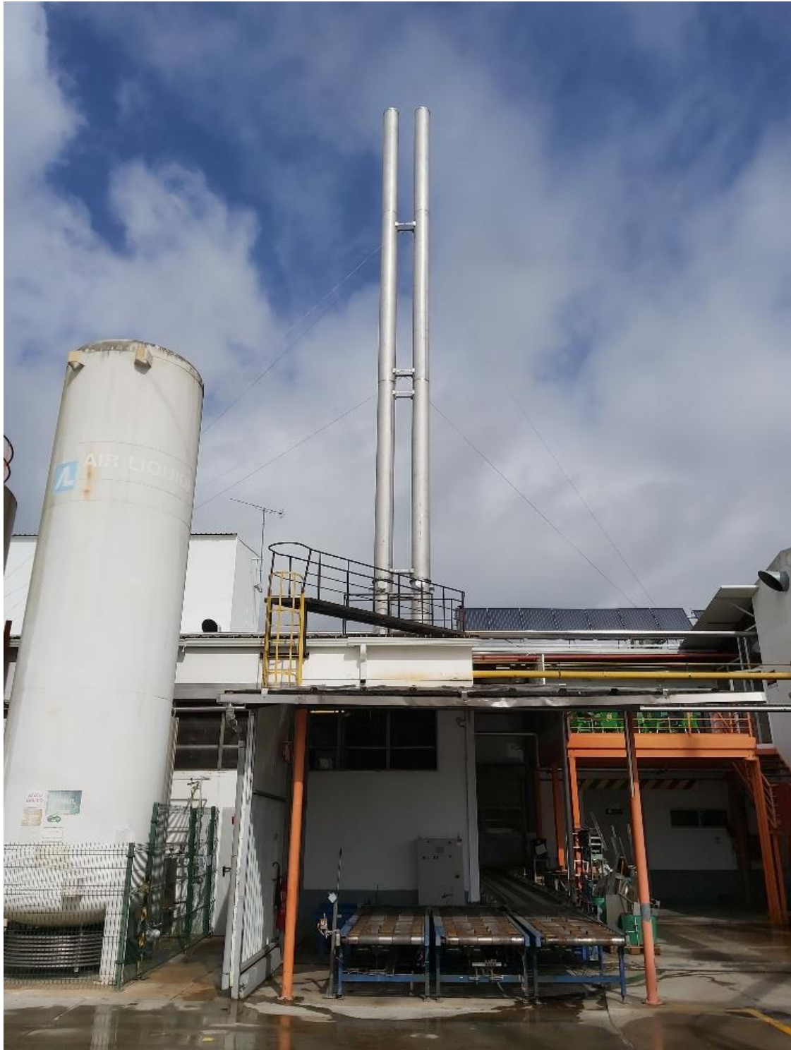
Imagem nº 2 – Chaminés dos geradores de vapor BOSCH e MORISA.
