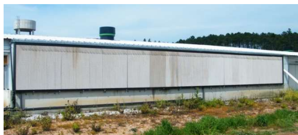
Figura 1. Painel evaporativo ou cooling existente numa exploração avícola do Grupo Lusiaves
