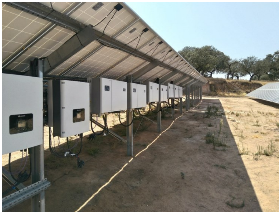
Fig. 7 - Exemplo de inversores de string acoplados à estrutura de suporte dos módulos fotovoltaicos
