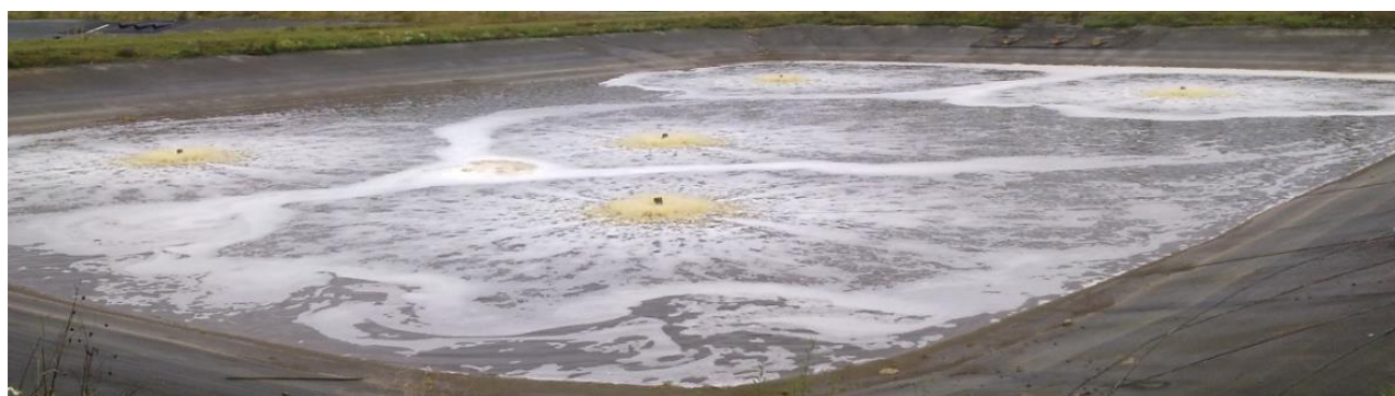
Figura 6 – Arejamento das lagoas
