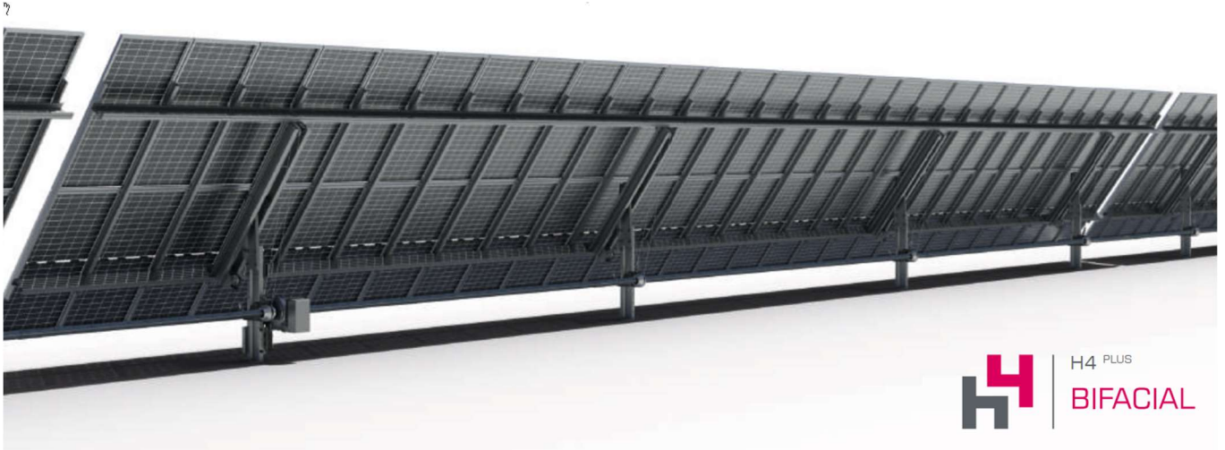
Figura 10 – Seguidor Horizontal a 1 eixo
