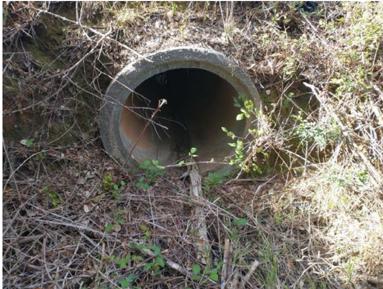
FOTO 1 – SAÍDA DE PH SEM MUROS ALA E SEM MURO TESTA
