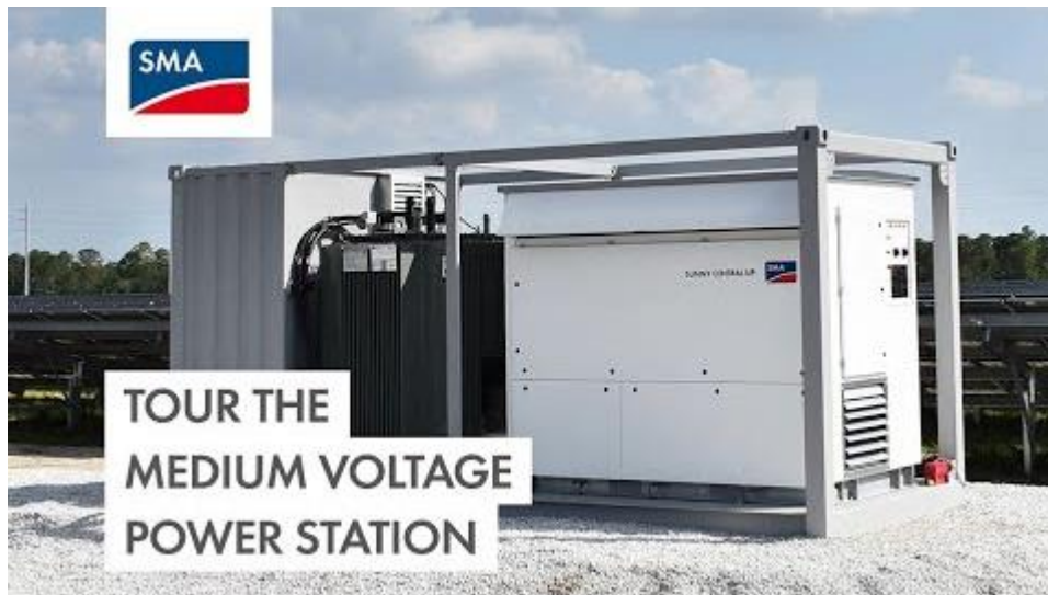
Figura 16: Posto de Transformação
