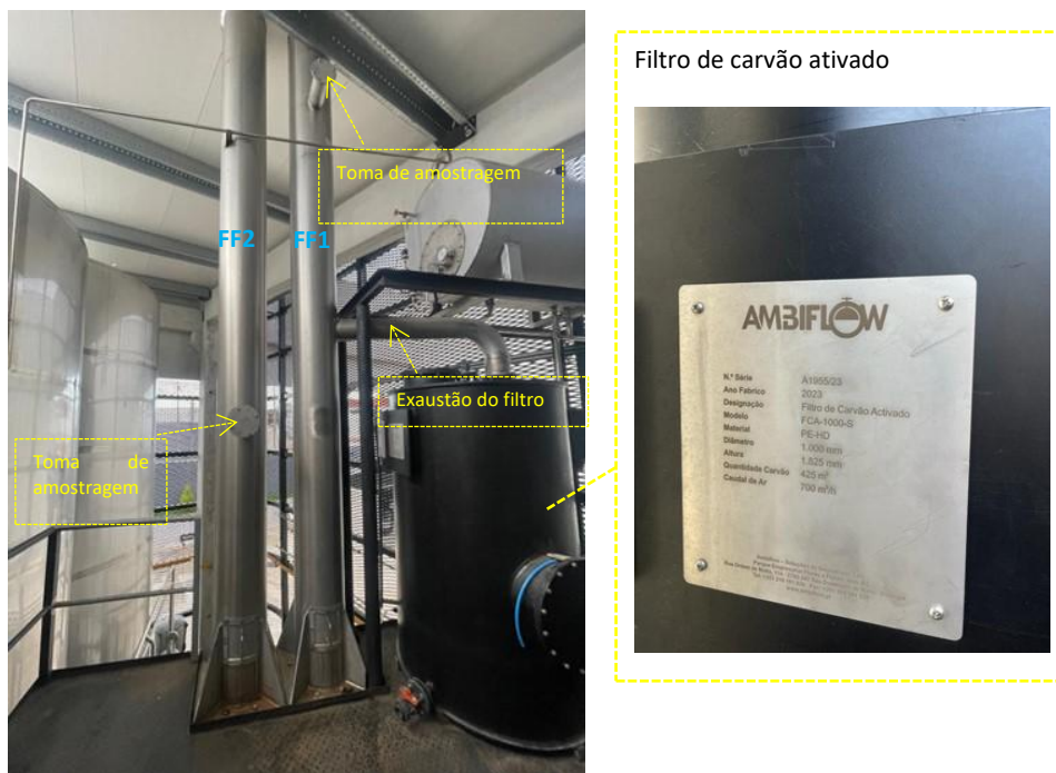
Figura 9 – Perspetiva das tomas de amostragem das chaminés FF1 e FF2, bem como do filtro de carvão ativado (Airflow FCA-1000 S) (piso intermédio).
