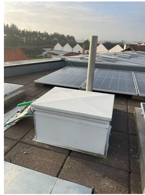
Figura 8 – Perspetiva da conduta de exaustão da hotte do laboratório da qualidade (FF3)
