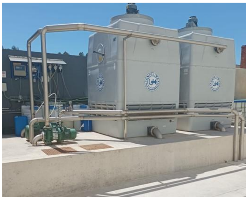
Figura 4 – Perspetiva das torres de arrefecimento da Vestan
