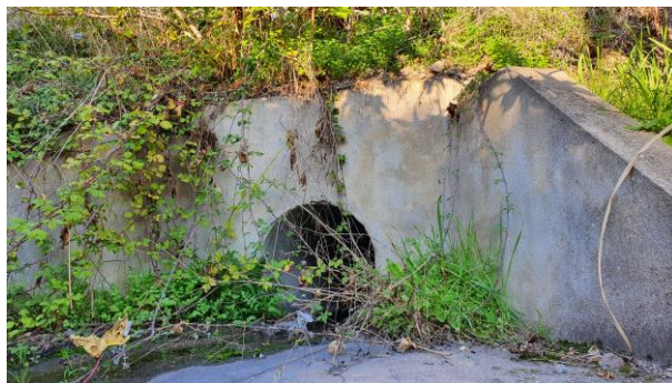
Figura 5 – Vista da boca de descarga da tubagem de águas residuais.
