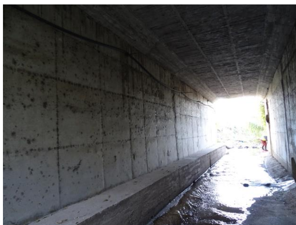
Figura 4 – Vista do maciço de protecção à conduta junto da base do montante Este.
