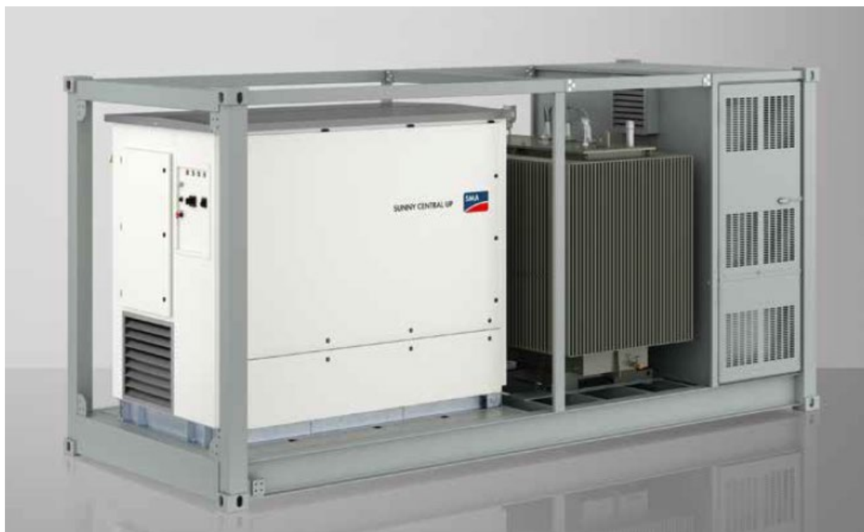
Figura 8 – Vista Geral do posto de transformação
